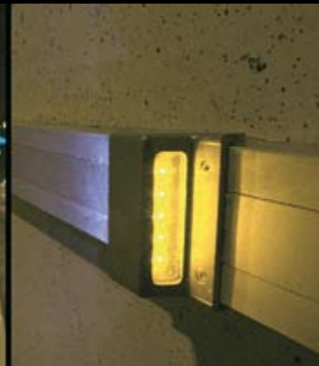
Los LEDs son ideales para la iluminación de zonas urbanas, viales y puentes por su bajo consumo y mantenimiento.
